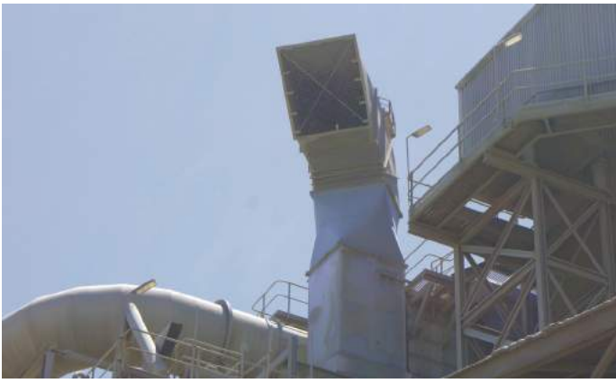
Rotation of gantry fan outlet.
